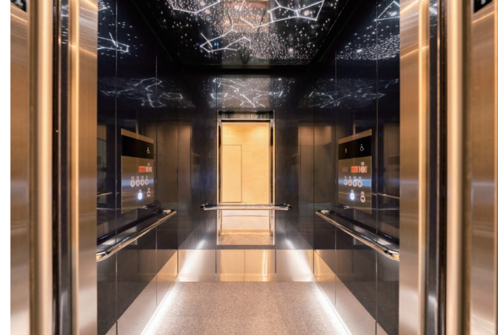
都内のプラネタリウム施設に設置したエレベーター。プラネタリウムらしく星がきらめく特注の天井となっている。
